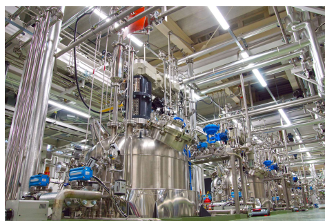
鶴岡本社の発酵パイロットプラント
